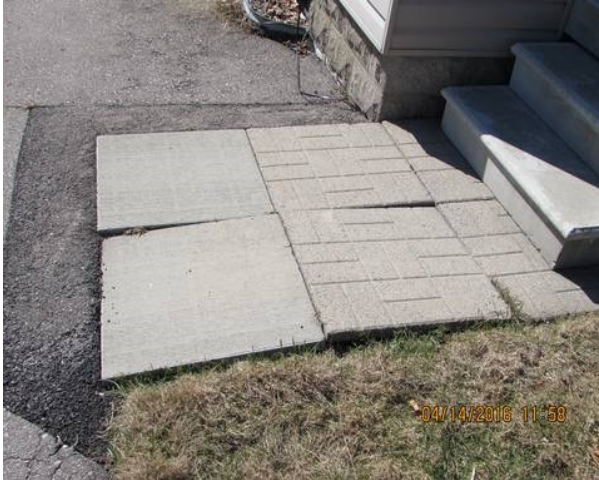
Uneven patio stones
